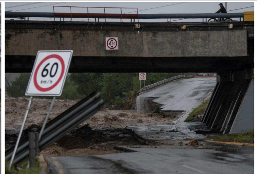
열대성 폭풍 '알베르토'로 인해 붕괴된 도로
