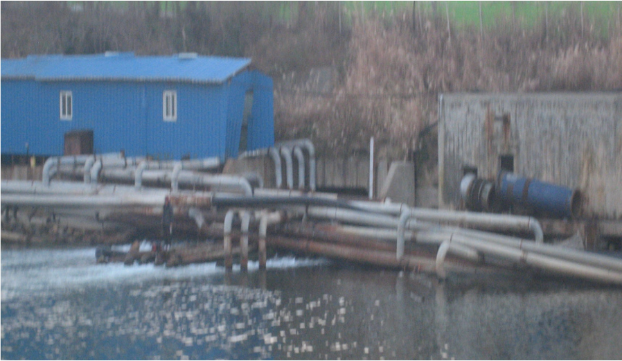
| 그림 3-6 | 영동화력발전소 온배수 취수 배관
