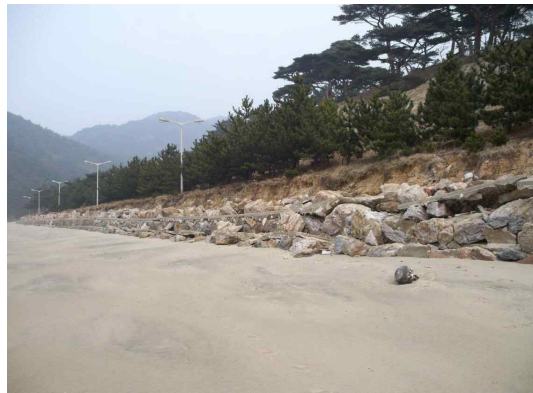
〈그림 2-10〉 호안붕괴 피해 예시 - 인천 대청면 대청리
