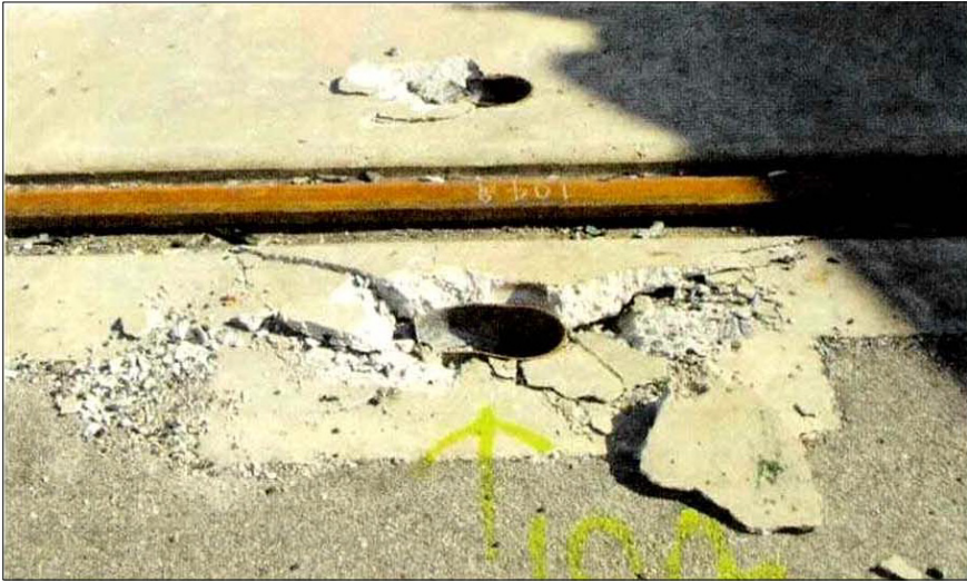
| 그림 2-4 | 신감만 부두의 104호기 파손 모습
