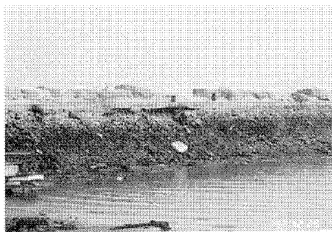
사진 9 파손된 북리항 방파제
