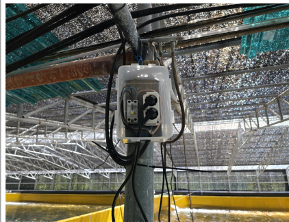
비상차단기가 설치된 전원 장치
